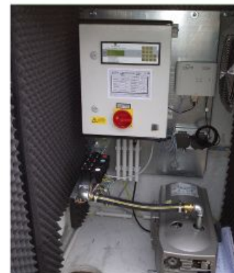
Armario de control
